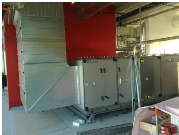
Figur 8.4: Installationer på översta våningen med olika fläktrum på UMAS.
