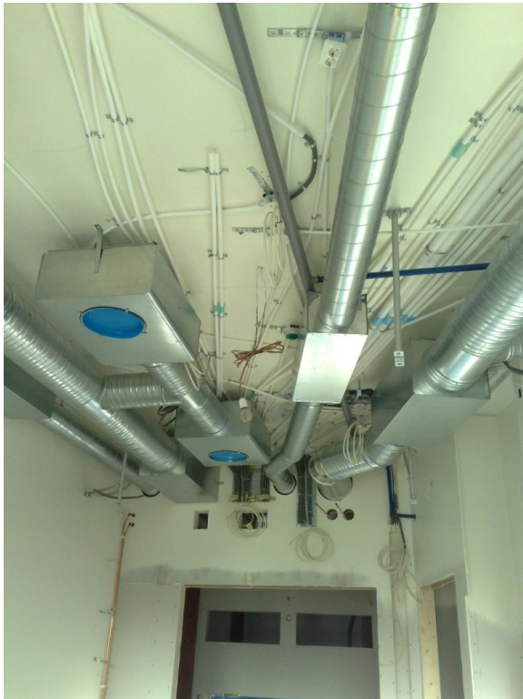
Figur 8.6: Installation i taket i ett renrum.
