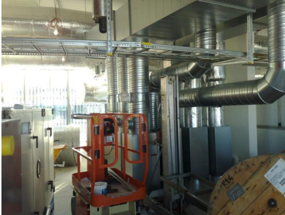
Figur 8.3: Installationer på översta våningen på UMAS.
